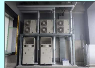
【冷凍庫 室外機】
