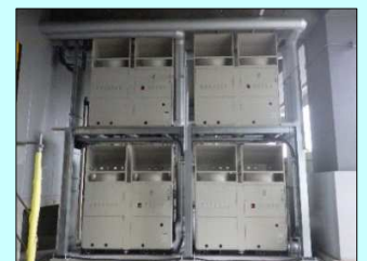
【チルド庫 室外機】
