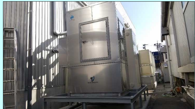
OMAチラーユニット（屋外設置）
