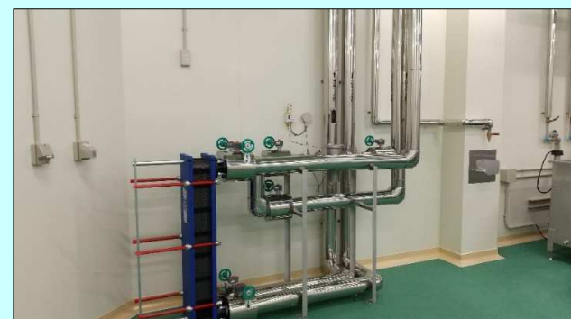
熱交換器（屋内設置）
