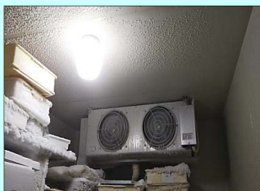
TKS設置後42日経過 (2020/01/10)
