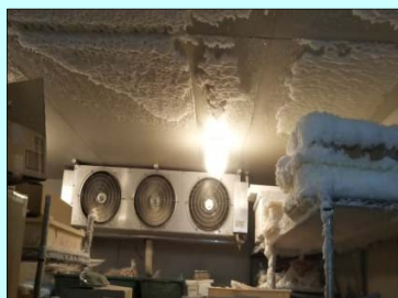
TKS設置後42日経過 (2020/01/10)
